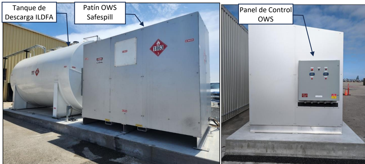
Figura 14-2: Patín OWS externo vista lateral junto al tanque de contención (izquierda) y vista final con panel de control (derecha)
