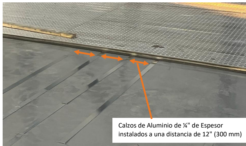
Figura 5-5: Ejemplo de instalación de calces bajo ILDFA.
