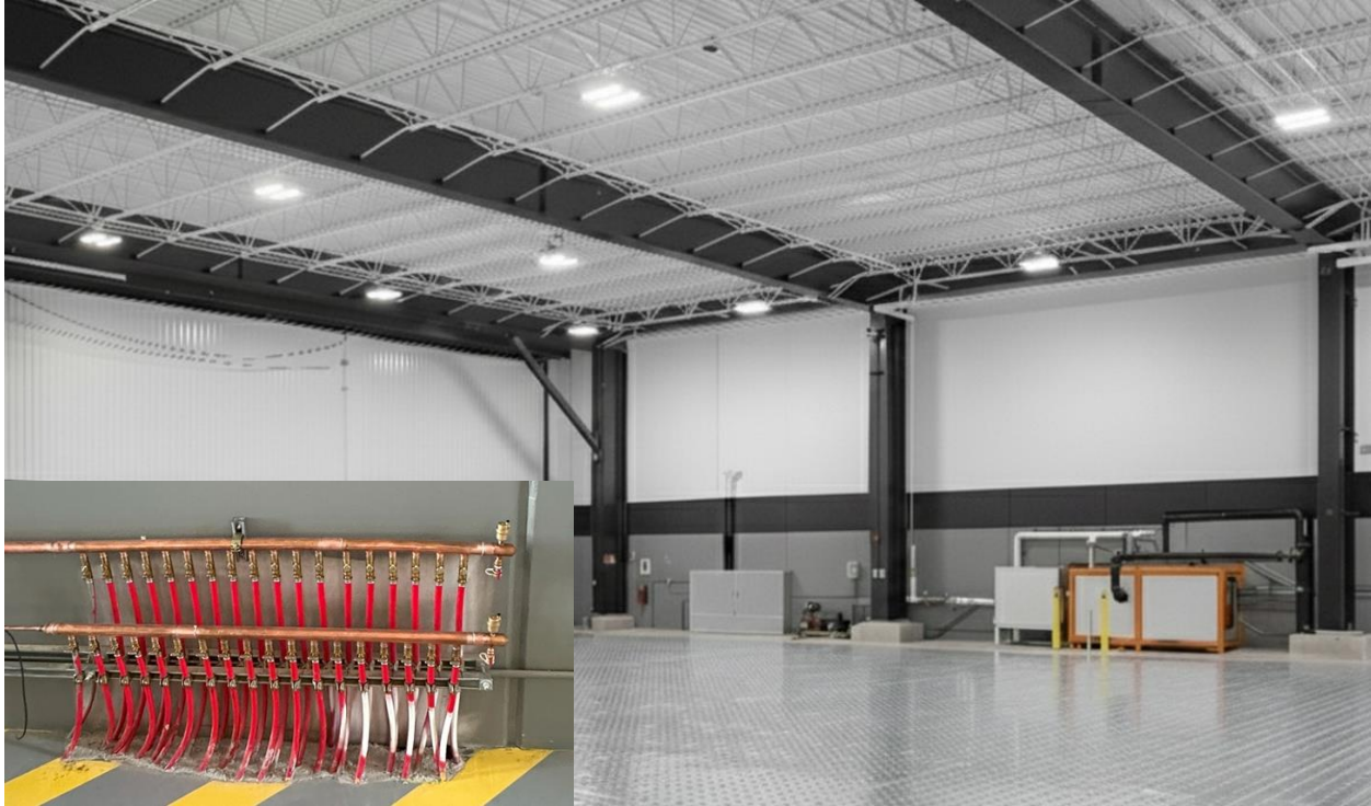
Figure 19-1 : Système de chauffage radiant intégré dans la dalle d'un hangar équipé d'un ILDFA
