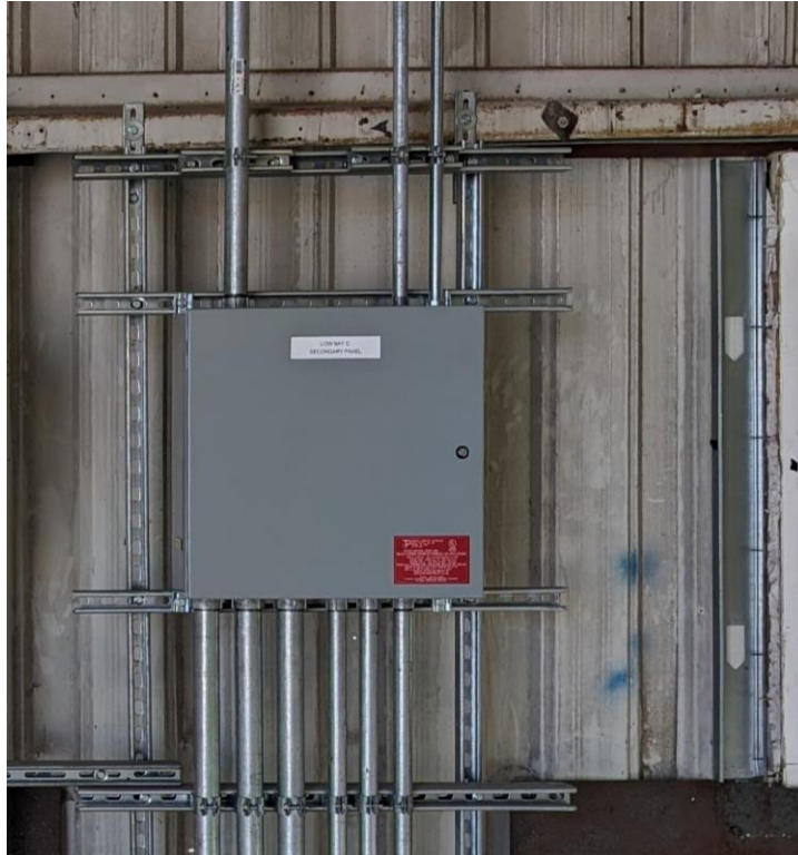
Figure 11-3 : Boîte de jonction de commande typique installée sur un mur à proximité d'une tranchée ILDFA
