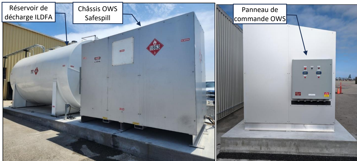
Figure 14-2 : Vue latérale externe du skid OWS à côté du réservoir de confinement (gauche) et vue d'extrémité avec panneau de contrôle (droite)
